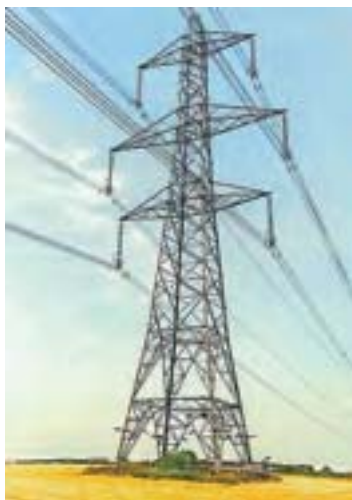
Рис. 68. Высоковольтная линия электропередачи
